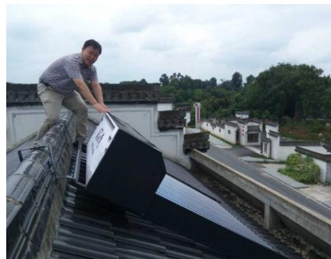
徽派建筑太阳能设备适宜性安装研究
